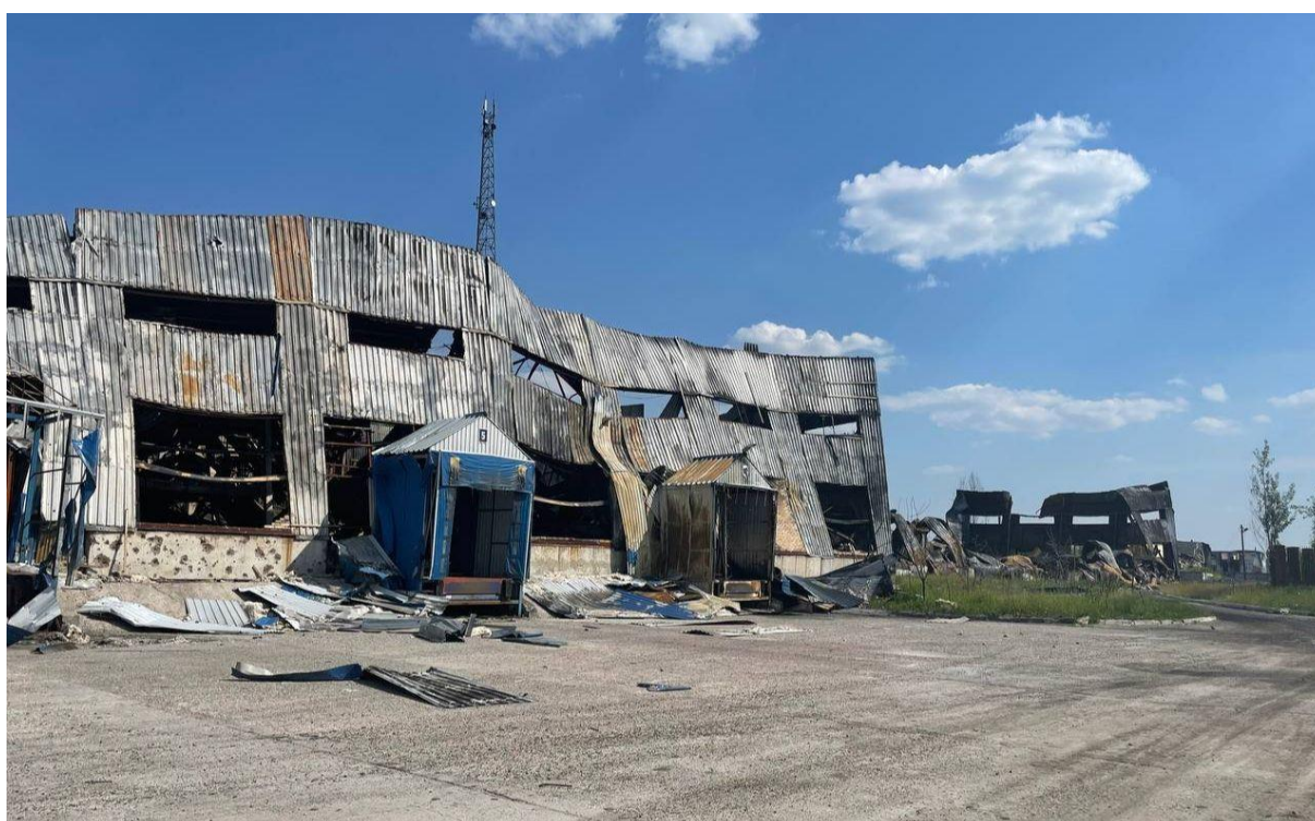
Рисунок 1.1 – Руйнування складських площ
