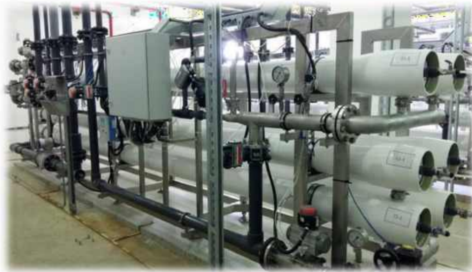
Рисунок 1 - Установка зворотного осмосу другого ступеня Склад системи:
