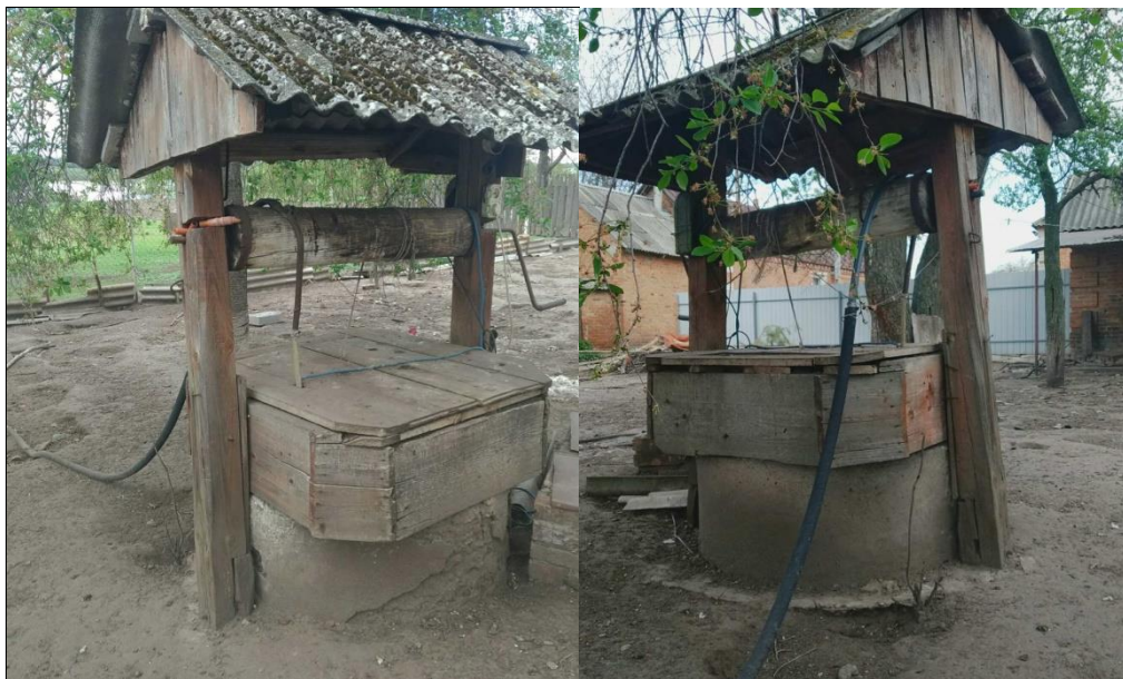
Рис. 3.2 – Зовнішній вигляд колодязя
