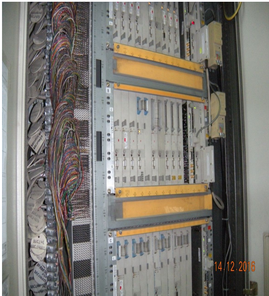
Рисунок 2.1 – Загальний вигляд шаф ТПТС-51, що встановлені на енергоблоці потужністю 325 МВт ТЕС
