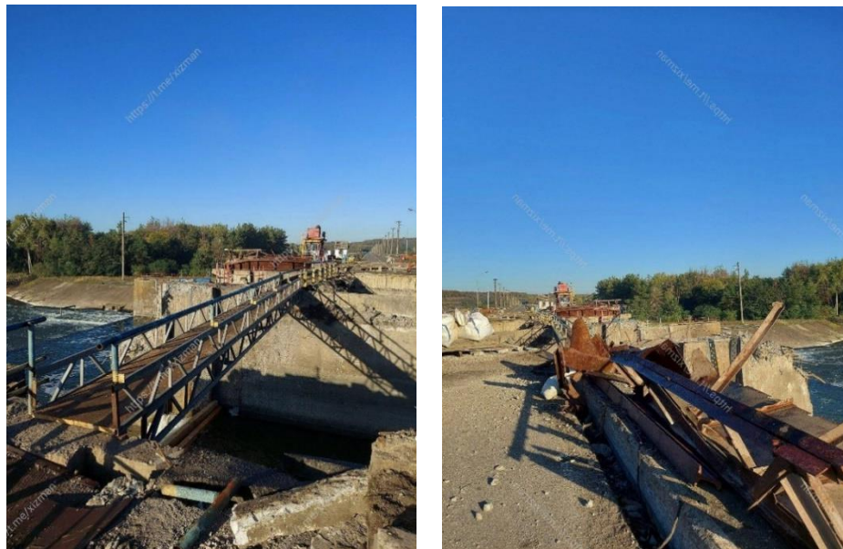
Рис.3.9. Зруйнована частина греблі Печенізького гідровузла, початок жовтня 2022 року. Фото взяті з телеграм-каналу «Північні новини»
