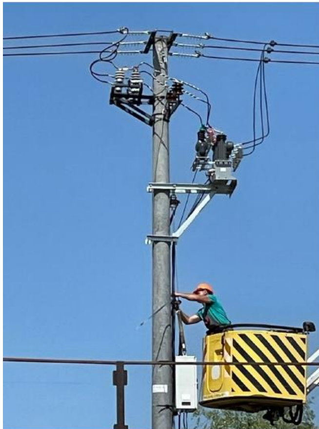
Рисунок 3.6 – Реклоузер повітряної лінії (Київські електромережі)
