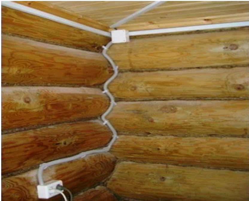
Рис. 6.1. Відкрита проводка у електротехнічній гофрі в дерев'яному домі
