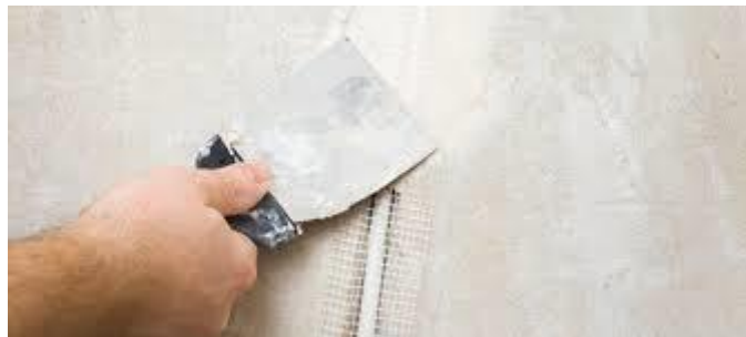
Рис. 6.6. Електропроводка під штукатуркою
