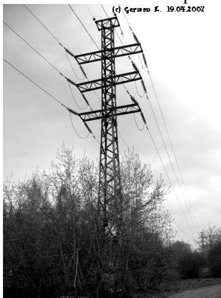
Рис. 1.2. Проміжна металева опора ПЛЕП 110 кВ
