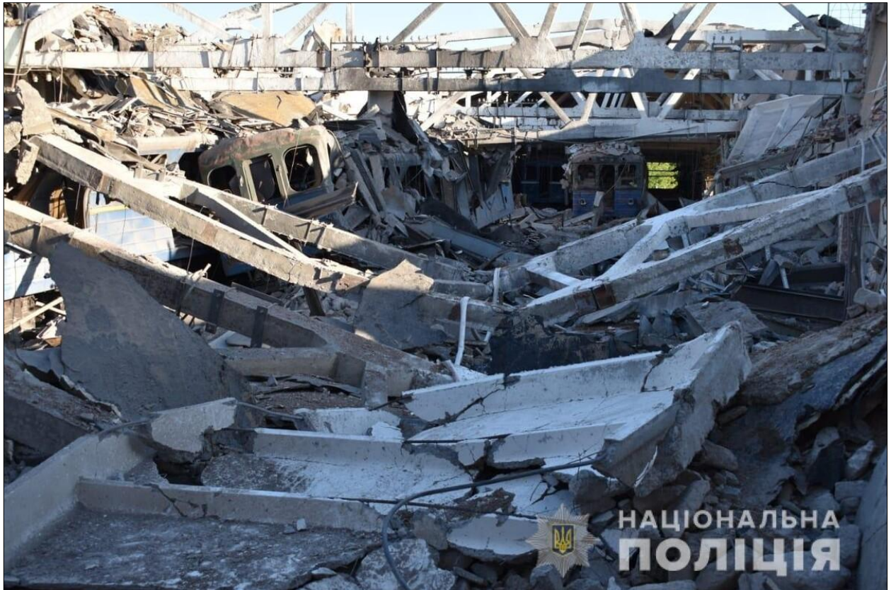
Рис. 3.5. Зруйноване Немишлянське електродепо у місті Харків [35]
