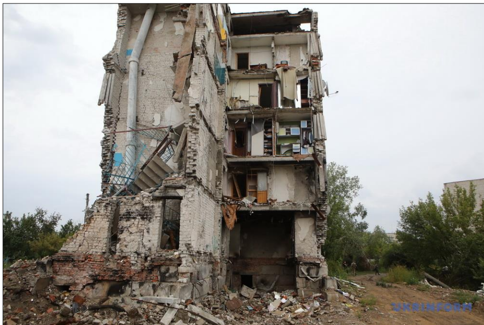
Рис. 3.8. Зруйнований житловий будинок внаслідок російського обстрілу [10]
