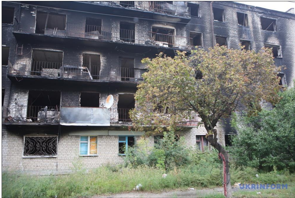
Рис. 3.10. Зруйнований житловий будинок внаслідок артилерійського обстрілу [10]
