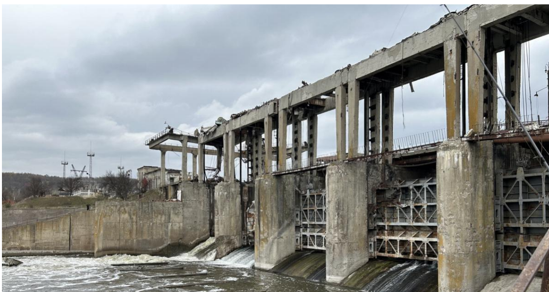
Рис. 1.2. Зруйнована гідротехнічна споруда Оскільського водосховища [1]
