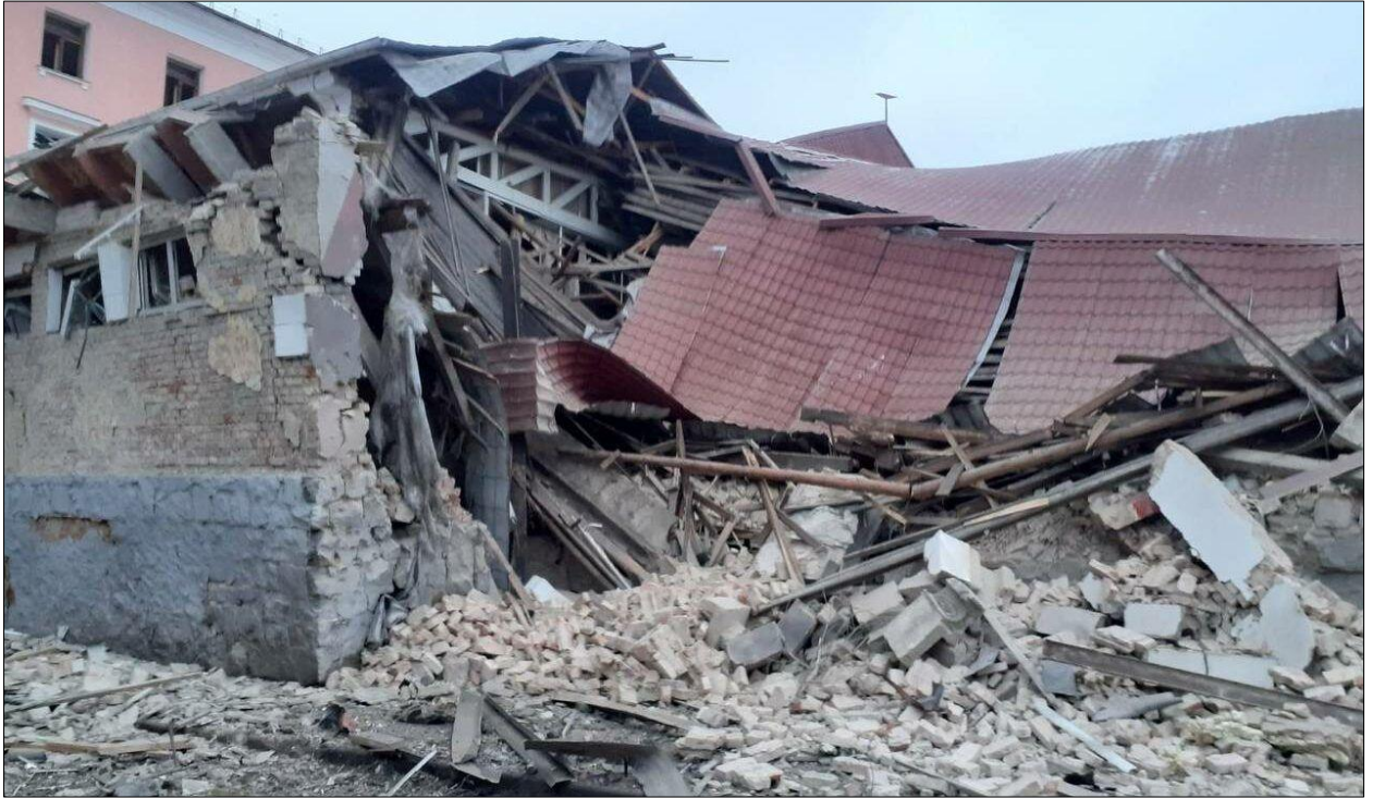
Рис.2.2 Зруйнований спорткомплекс СК Локомотив у Києві [47]
