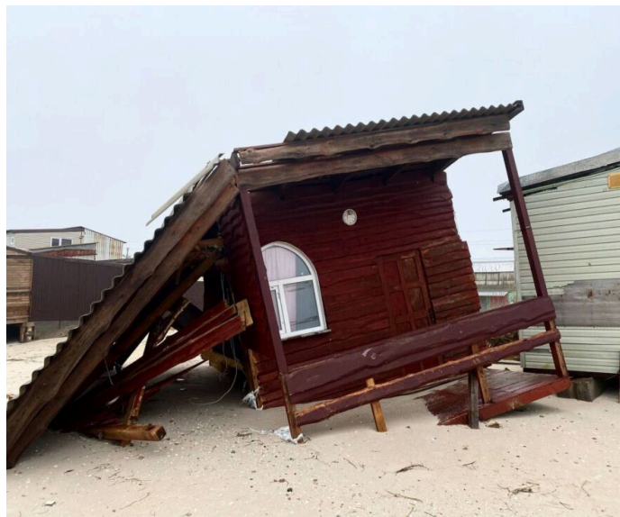
Рис. 2.16.б. Зруйновані пляжні будинки [33]
