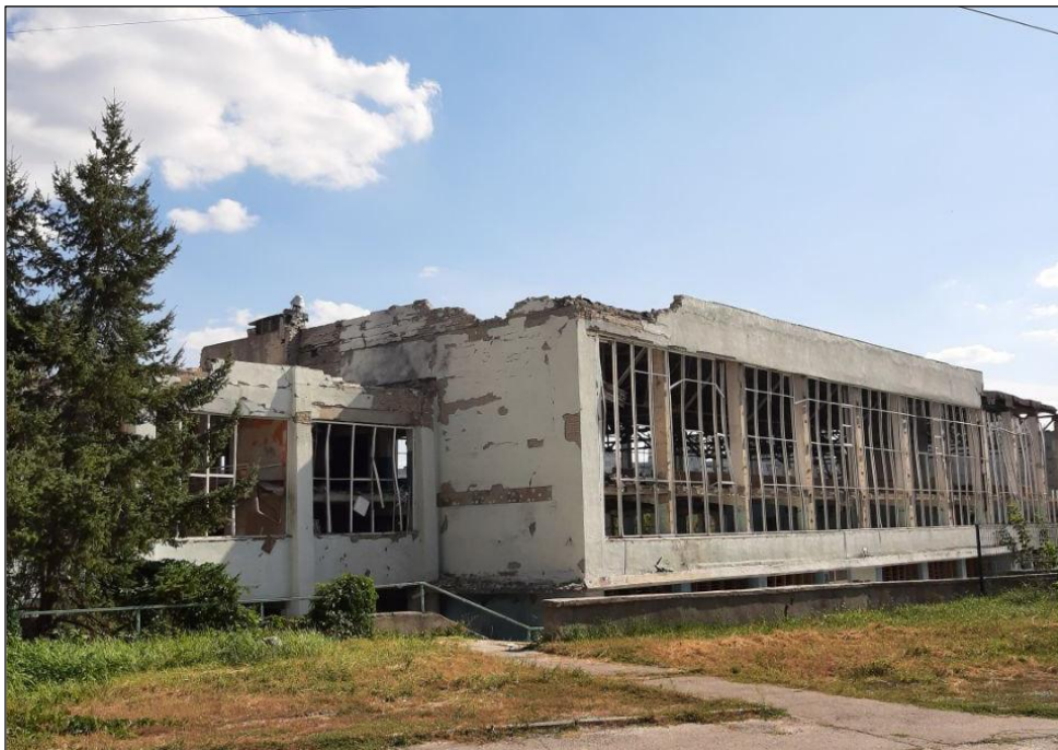
Рис.3.8. Зруйнована будівля спортивного комплексу "Уніфехт" (зроблено автором)
