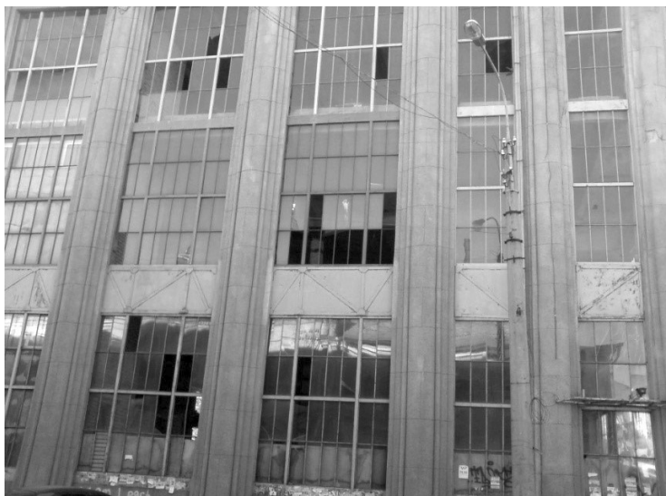
Рис. 3. Сквозь окна видно неудовлетворительное состояние конструкций каркаса здания
