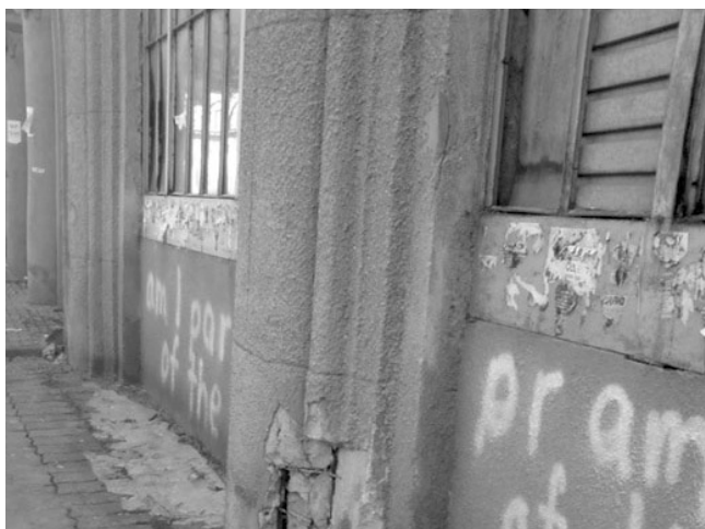
Рис. 4. Разрушение защитного слоя бетона и коррозия арматуры ригеля каркаса
