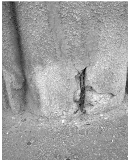
Рис. 5. Разрушение защитного слоя бетона и коррозия арматуры
