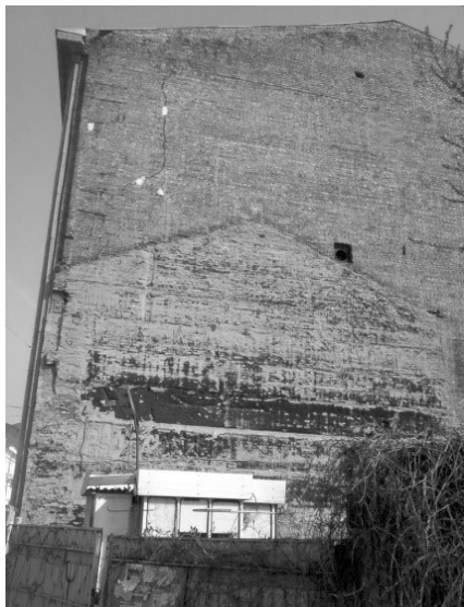
Рис. 6. Трещины в торцевой стене
