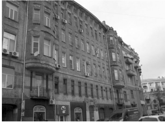
Рис. 11. Фасад здания. Коррозия металла балок эркеров
